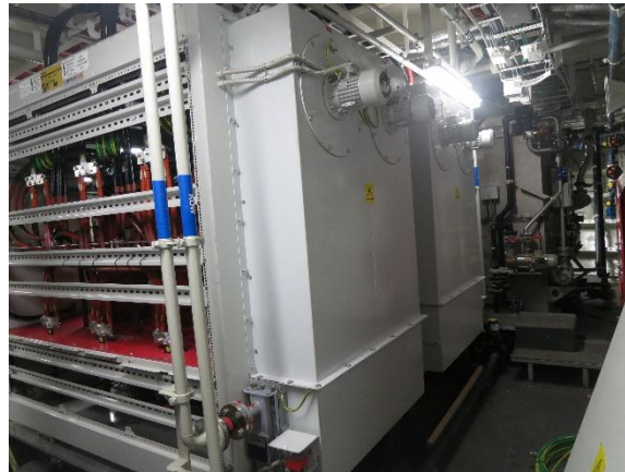
Veel transformatoren (zwaar / groot)
