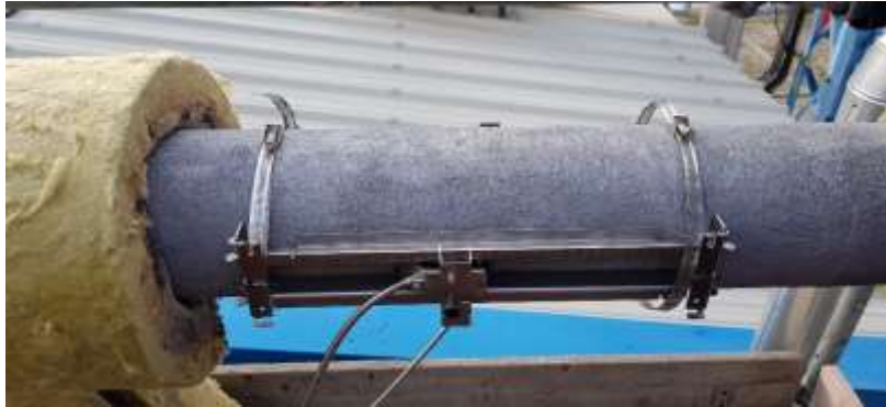
Leiding geverfd met dempingsverf, ter voorkoming van accoustische ruis
