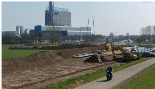
▲ Het restwarmte van de afvalverbranding in Duiven wordt de wijk Schuytgraaf in Arnhem verwarmd. Gasleidingen zijn er niet te bekennen. © Bart Hammen
